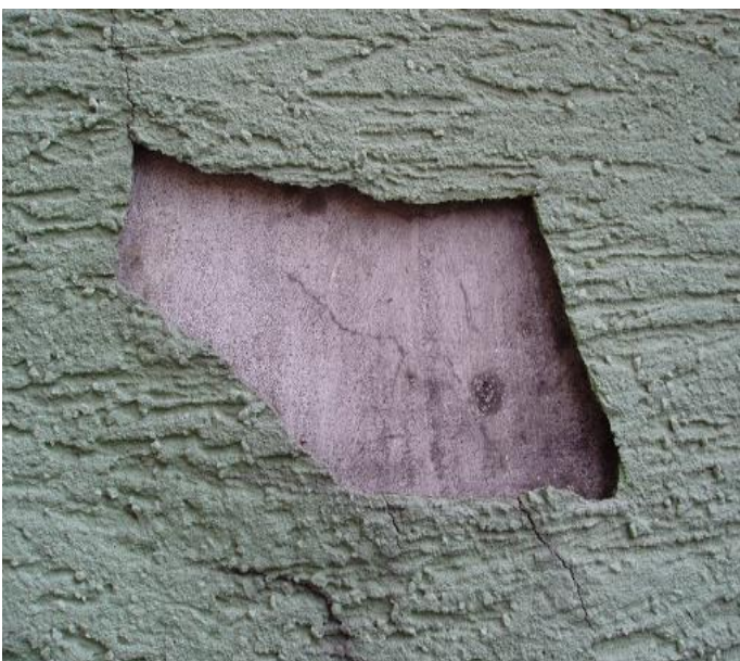
Nałożenie tynku na warstwę zbrojącą ze skażeniem biologicznym, odpadanie tynku
