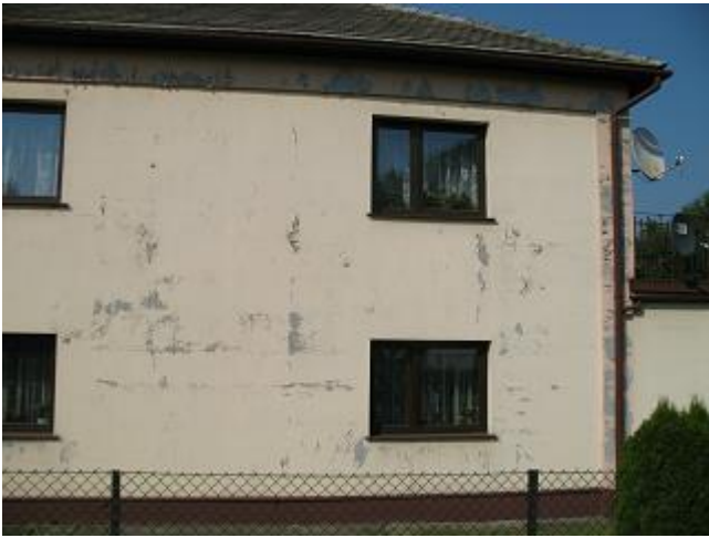
Źle przygotowane podłoże, odpadanie farby od podłoża
