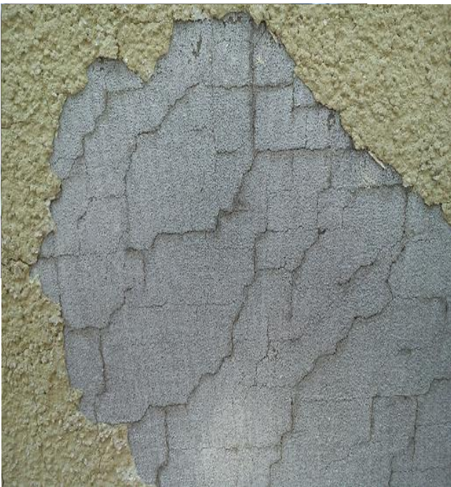
Nakładanie kleju w niesprzyjających warunkach pogodowych. Destrukcja warstwy zbrojącej, odpadanie tynku.
