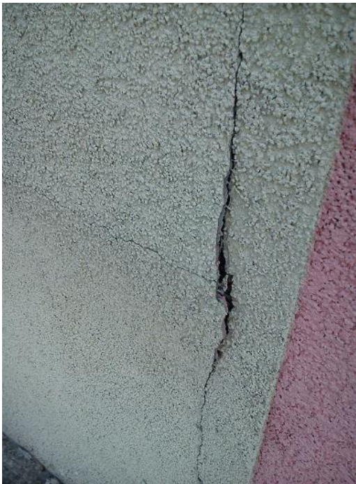
Brak zakładu na siatce zbrojącej, pęknięcie warstwy zbrojącej
