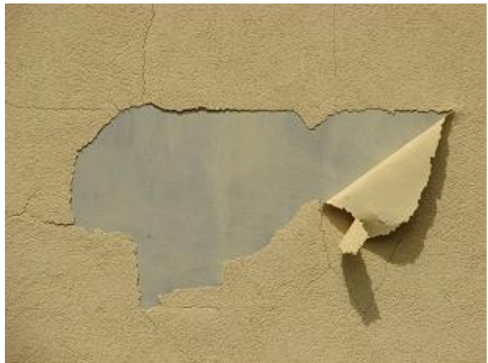
Aplikacja tynku w wysokich temperaturach, brak kompatybilności systemu, skutek odpadanie tynku
