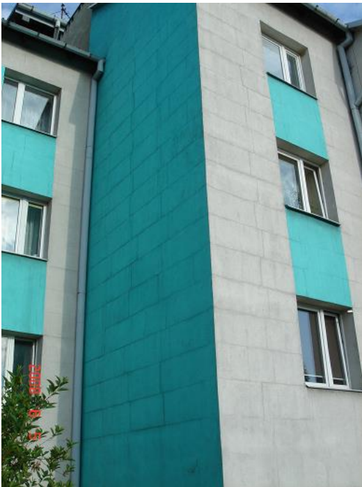
Nie zastosowano siatki zbrojącej, pęknięcia warstwy kleju
