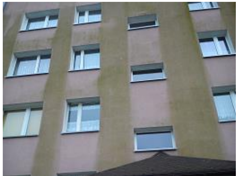
Rejon nadmorski zastosowano tynk bez zabezpieczenia powłoki przed algami i glonami. Widoczne skażenie biologiczne.
