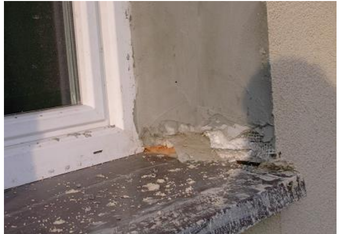
Nieprofesjonalne wykonanie ościeża, brak możliwości nałożenia tynku
