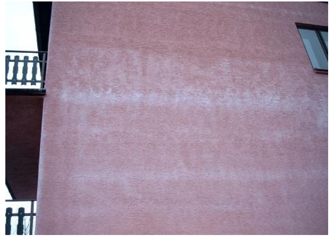
Malowanie nie wysezonowanego tynku mineralnego, widoczne wykwyty wapienne
