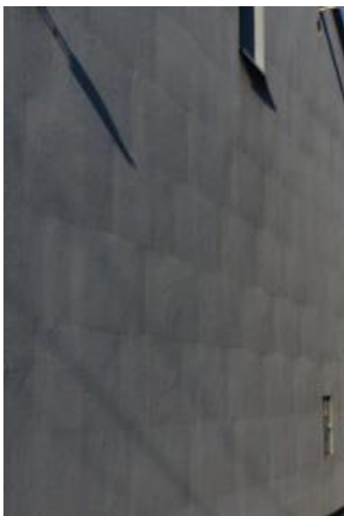
Zastosowano nie sezonowany styropian, kurczenie się płyt, widoczny defekt
