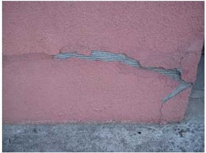
Brak dylatacji w połączeniu z płytą betonową, podnoszenie płyty betonowej powoduje pęknięcie warstwy zbrojącej ocieplenia
