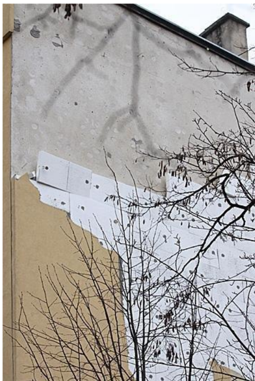
Nieodpowiednio przygotowane podłoże, brak kołkowania doprowadziło do oderwania styropianu.
