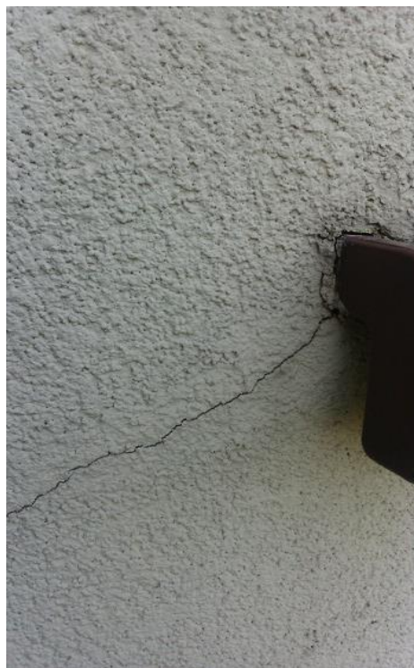
Brak siatki diagonalnej w narożach otworów okiennych, pęknięcia warstwy zbrojącej, pęknięcia tynku
